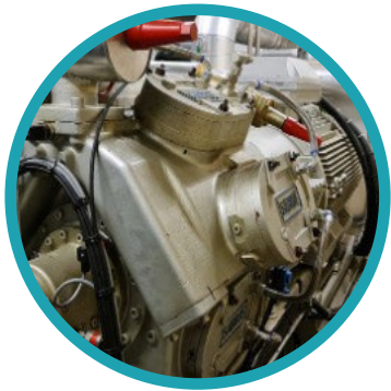
Varmepumpe som primær varmekilde
